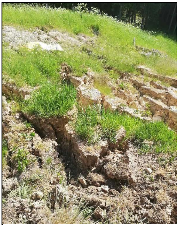
Slika 8 Ispucala glinovita drobina, hrapavih zidova, isušena na vetru - zona trbuha klizišta „Mandići” - 13.6.2019. g.
