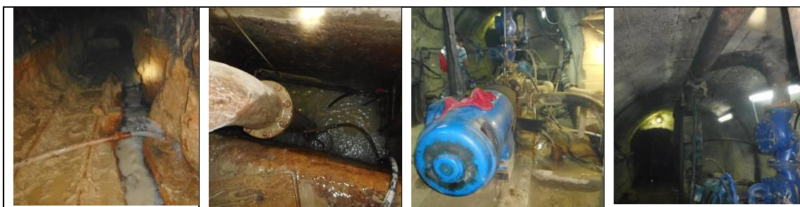
Слика 7. Приказ главног водосабирника на хоризонту -170 и хидромашинске опреме
