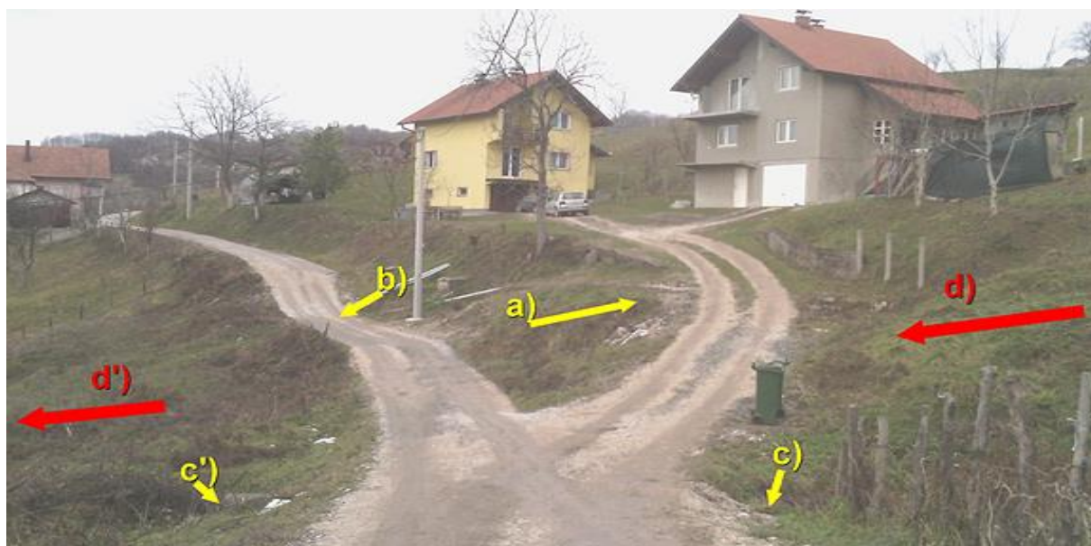
Slika 1. Prikaz a-b) nivelete puta Lipovice-Meškovići prije aktiviranja klizišta, smičuće deformacije sa denivelacijom (konkavnim udubljenjem puta), c-c') interventno-neadekvatno izvođenje propusta ispod puta, d-d') pravac aktivnosti klizišta. (Foto J. Čomić, januar 2018 godine).
